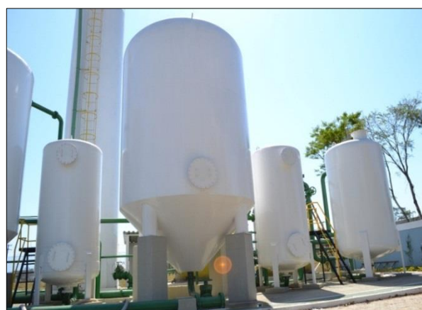
Figura 21 – Unidades de tratamento
