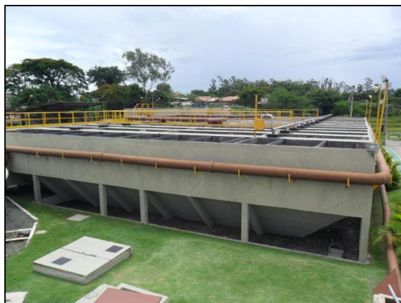
Figura 56 – Reator UASB e biofiltro aerado.
