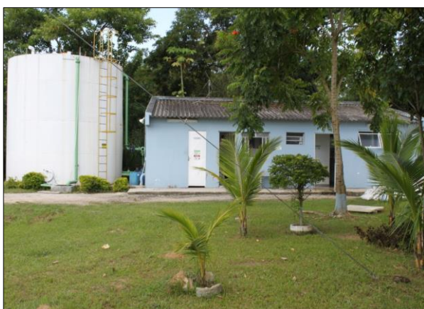
Figura 23 – Vista da ETA São Caetano
