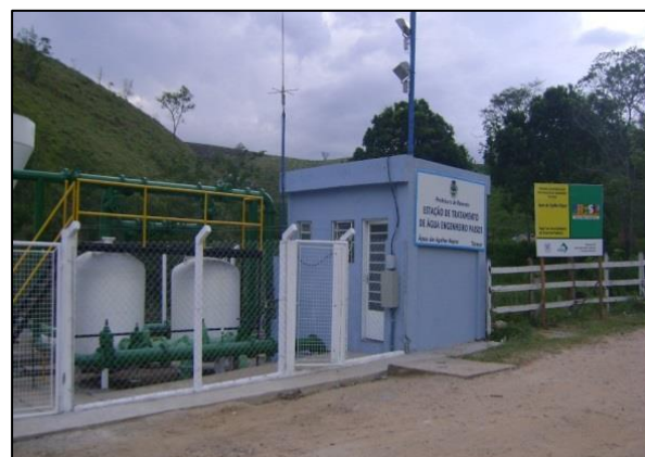
Figura 31 – Vista da ETA Engenheiro Passos
