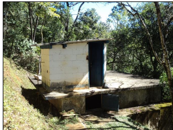
Figura 51 – Unidade de reservação
