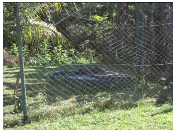
Figura 68 – Vista da Elevatória de Esgoto Bruto da ETE Fumaça
