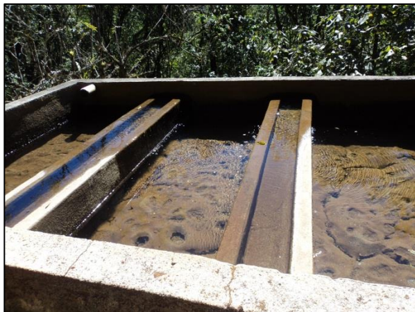
Figura 50 – Unidade de filtração
