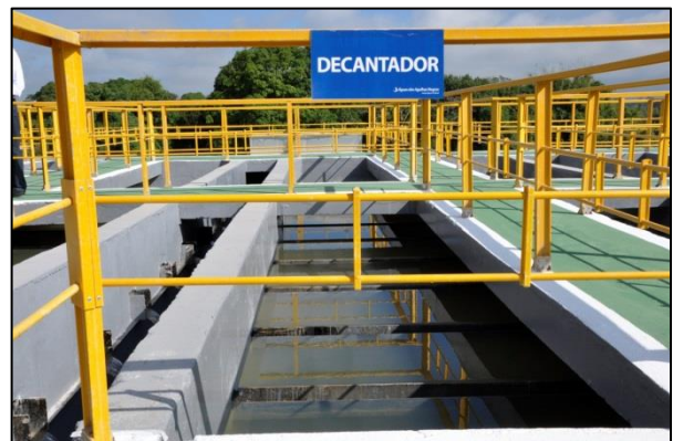
Figura 12 – Decantador do novo módulo - ETA Alegria
