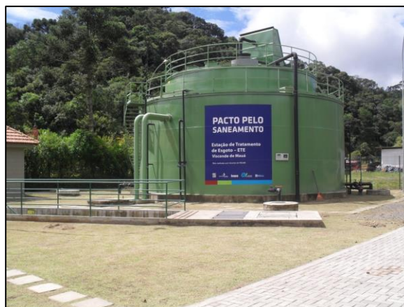
Figura 66 – Unidade de Tratamento
